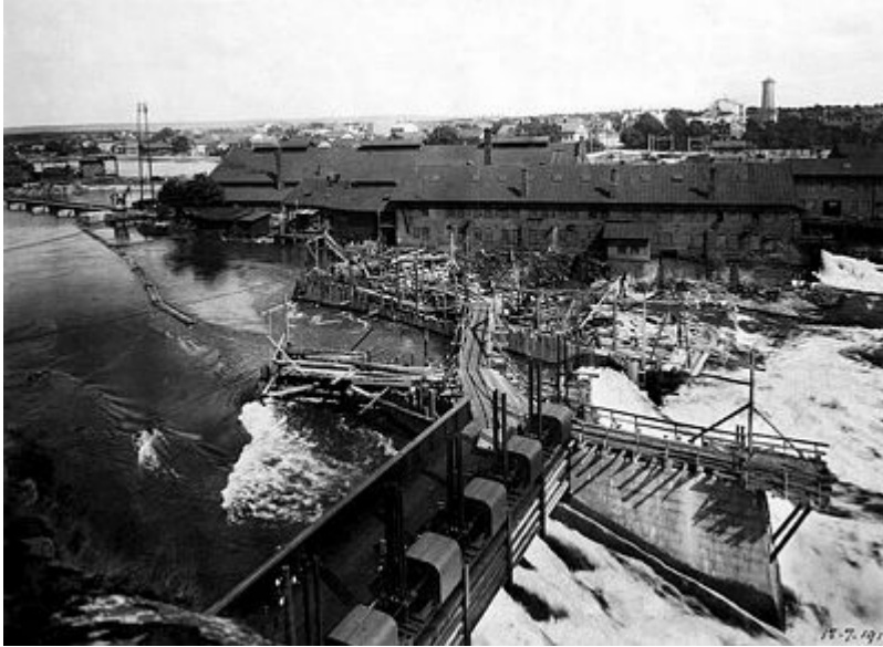
Regleringsdamm till Olidans kraftverk under byggnad 1911. I bakgrunden Stridsberg & Björcks fabrik före flytten till Källstorp. Bildkälla: Innovatum Bildarkiv
